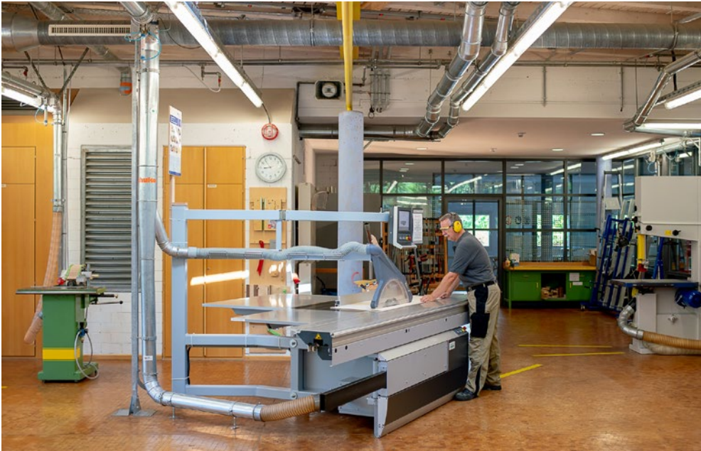
Abb. 2.2.3-01 Absauganlage an einer Holzbearbeitungsmaschine
